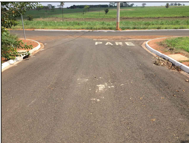
Foto 11: Vista da Rua José Torrente para a esquina com a Rua João Fernandes, mostrando bocas de lobo simples nas laterais e dupla ao fundo.
